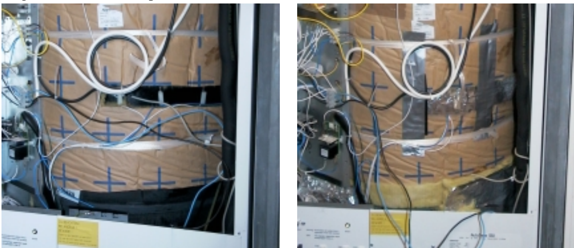
Abb. 6: links: Boiler ab Werk, Boden und ein Schlitz von ca. 6 cm Breite sind nicht isoliert; rechts: Der Boden und der Schlitz wurden nachträglich isoliert
